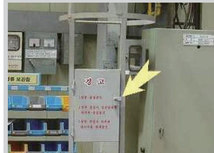
크레인 점검통로 입구 잠금장치
