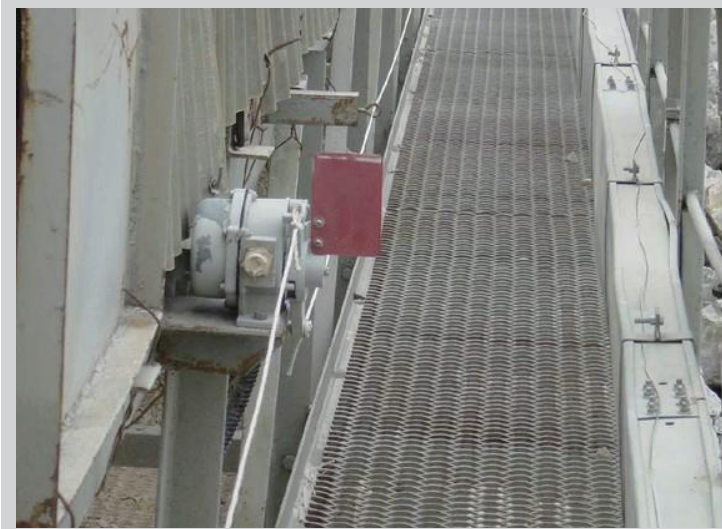
컨베이어 비상정지장치(풀코드 스위치) 설치
